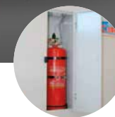
Automatic extinguishing system Automatický hasičí systém
